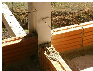
Fotografia 121 - Locação da alvenaria. Observar que a estrutura metálica já está protegida com "primer".
