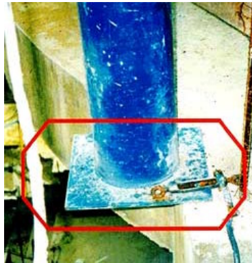
Fotografia 104 - Exemplo de má locação de uma obra onde o cinto em concreto foi executado menor que o previsto em projeto, ficando o pilar fora da base de fundação.
