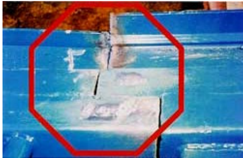
Fotografia 96 – Falha em ligação soldada por falta de concordância em emenda de perfis.
