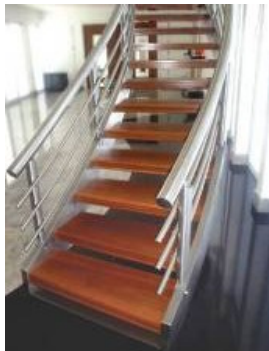
Fotografia 194– Exemplo de uso aço inox em escada.
