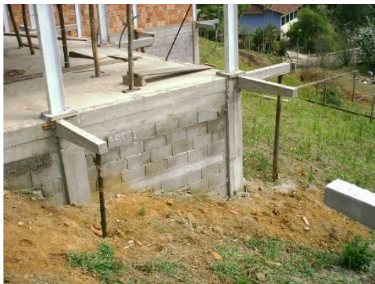
Fotografia 105 - Nesta obra residencial, pela própria declividade do terreno, a estrutura fica distante do solo.
