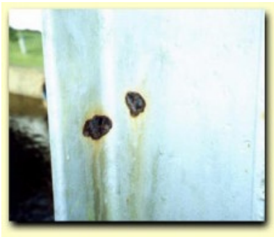
Fotografia 189 -Exemplo de corrosão puntiforme.
