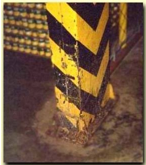
Fotografia 103 - Exemplo de pilar em contato direto com o piso, à mercê de umidade, com sua base completamente atacada pela corrosão.
