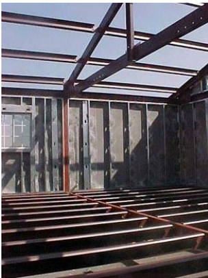
Fotografia 141- Exemplo de execução de residência, nos Estados Unidos, com painel GFRC e estrutura em aço leve, dobrado a frio .
