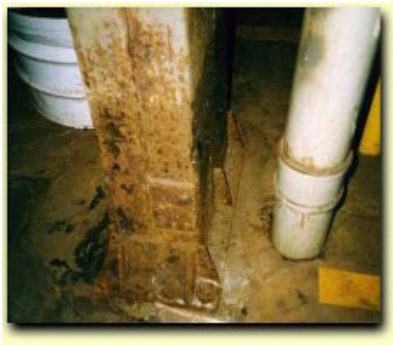
Fotografia 187- Exemplo de corrosão por placas.
