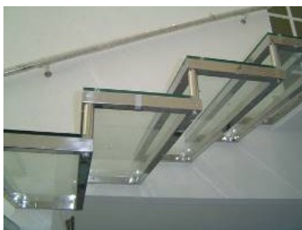
Fotografia 195– Exemplo de uso aço inox em escada.
