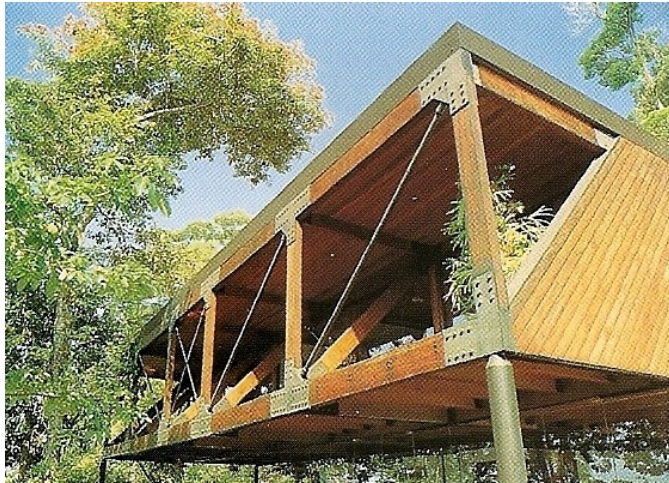
Fotografia 166 - Detalhe do uso do aço com a madeira. Local: Rio de Janeiro, RJ, Brasil.
