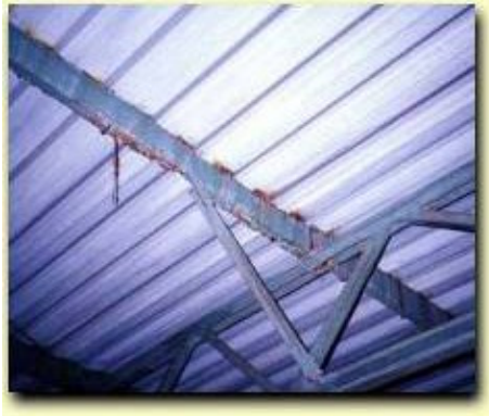
Fotografia 188 -Exemplo de corrosão galvânica.
